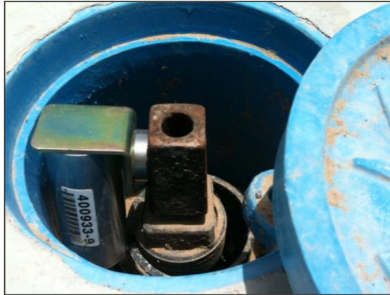
Figura 1.4 Logger Acústico instalado en un eje de válvula con un soporte en ángulo
