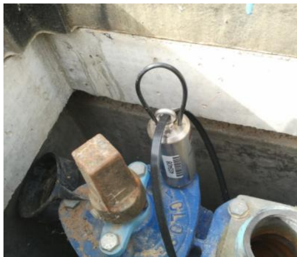
Figura 1.6 Logger correlador de ruido asegurado al hidrante con un cable de acero
